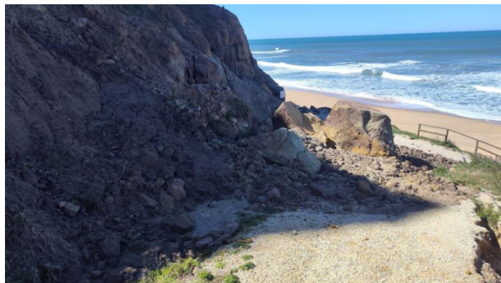
Imagem 2 – identificação de deformações estruturais, abatimentos e perda de suporte lateral
